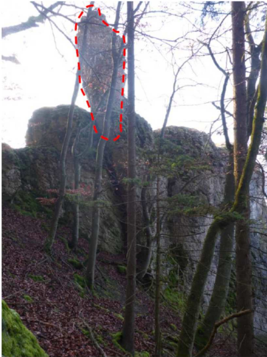
Abb. 1: schiefstehender Felsturm mit aufgelockertem Fußbereich, Foto: 13.12.2017
