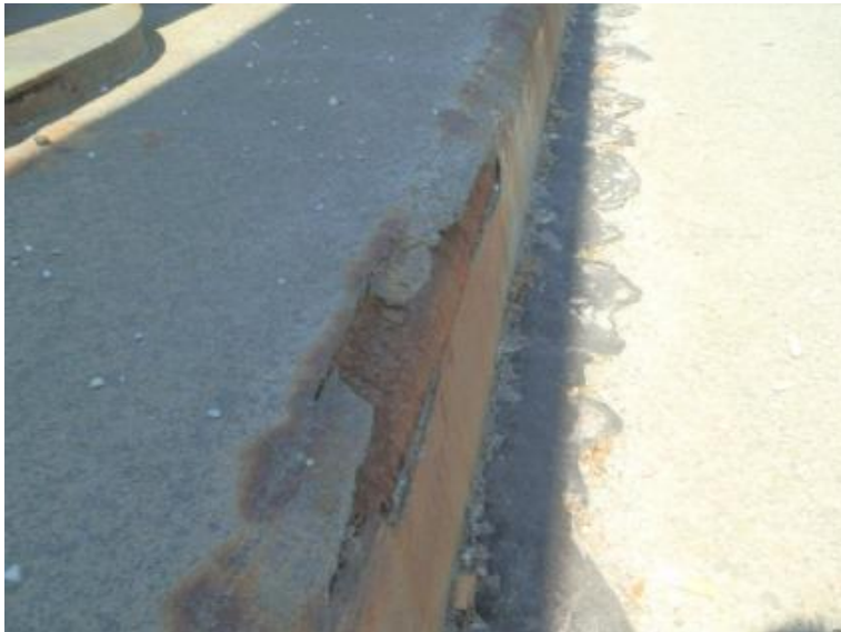
Ausgewählte Schäden oberliegenden Tragwerk
